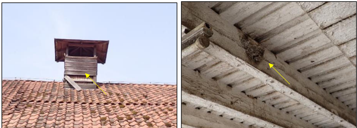
Abbildung 8: Holzverkleideter Schornstein an Gebäude B mit Potenzial für gebäudebrütende Vögel und gebäudebewohnende Fledermäuse (linkes Bild) und altes Rauchschnalbenest (rechtes Bild).
