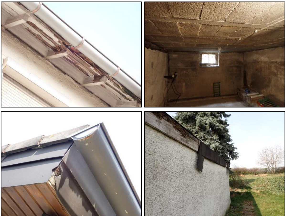
Abbildung 5: Schadstellen an den Gebäuden B (links oben) und A (links unten) mit potenziellen Einflugmöglichkeiten, potenzielle Spaltquartiere hinter Holzverkleidung an der Garage im Norden von Gebäude A und Keller mit potenzieller Eignung als Sommerquartier für Fledermäuse.
