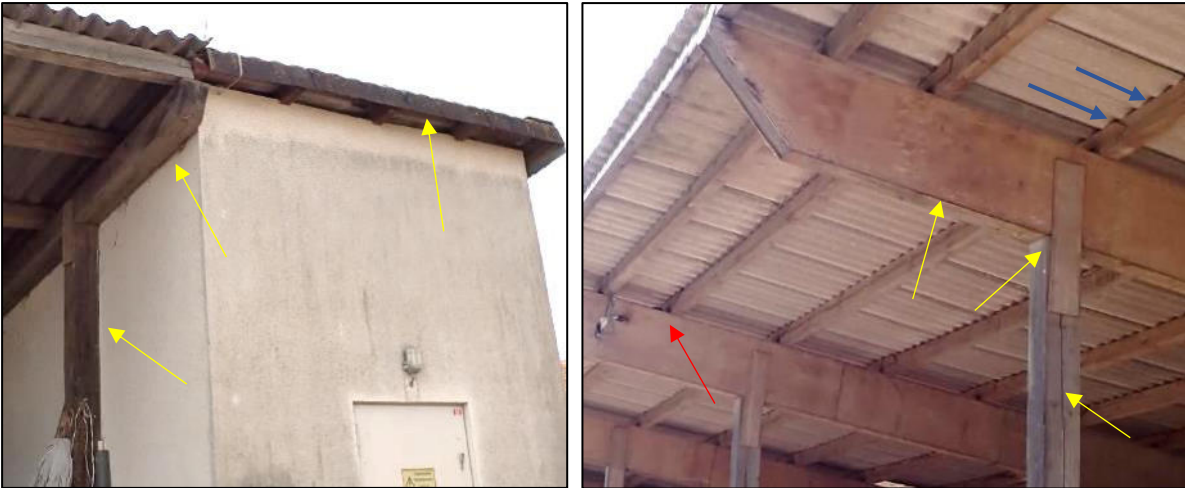
Abbildung 9: Einzelquartiermöglichkeiten für Fledermäuse in Form kleiner Spalten am gemauerten Teil des Gebäudes E (linkes Bild, gelbe Pfeile) und den Holzbalken des Gebäudes F (rechtes Bild, gelbe Pfeile). rote Pfeil rechtes Bild: Standort eines alten Vogelneests, vermutlich einer Amsel blauen Pfeile rechtes Bild: beispielhafte Nischen zwischen Wellblech und Balken mit potenzieller Eignung als Brutstätten für gebäudebrütende Vogelarten.
